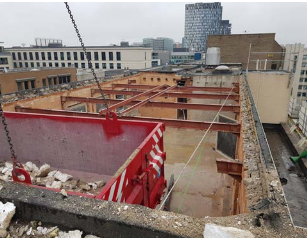
Pendant la phase de démolition, le data centre situé aux niveaux R0 et R-1 est resté actif.
